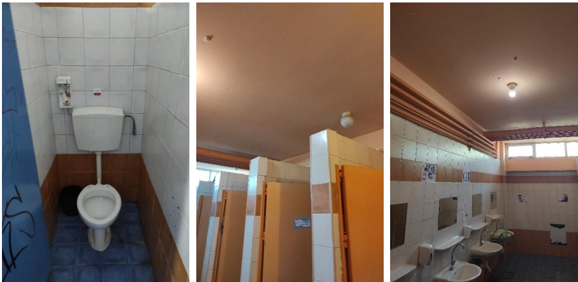
Εικόνα 4. Υπάρχουσα κατάσταση χώρων υγιεινής του σχολικού συγκροτήματος.
