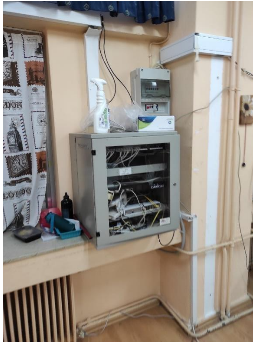
Εικόνα 3. Υφιστάμενο ερμάριο (Rack) δομημένης καλωδίωσης του σχολικού συγκροτήματος.
