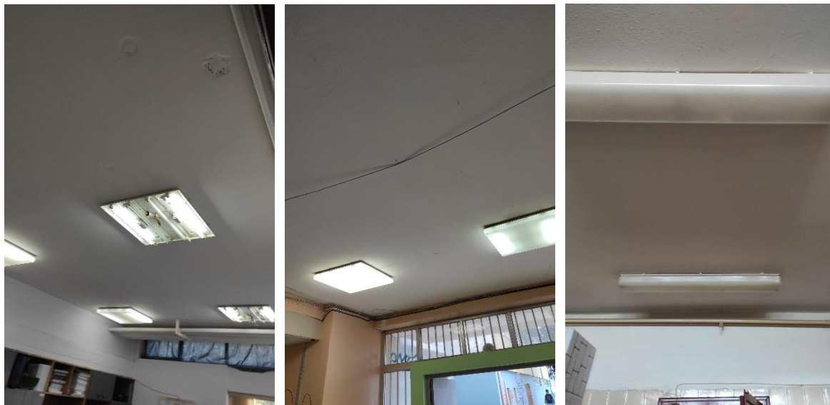
Εικόνα 2. Γραμμικά και τετράγωνα φωτιστικά σώματα φθορισμού στο σχολικό συγκρότημα.
